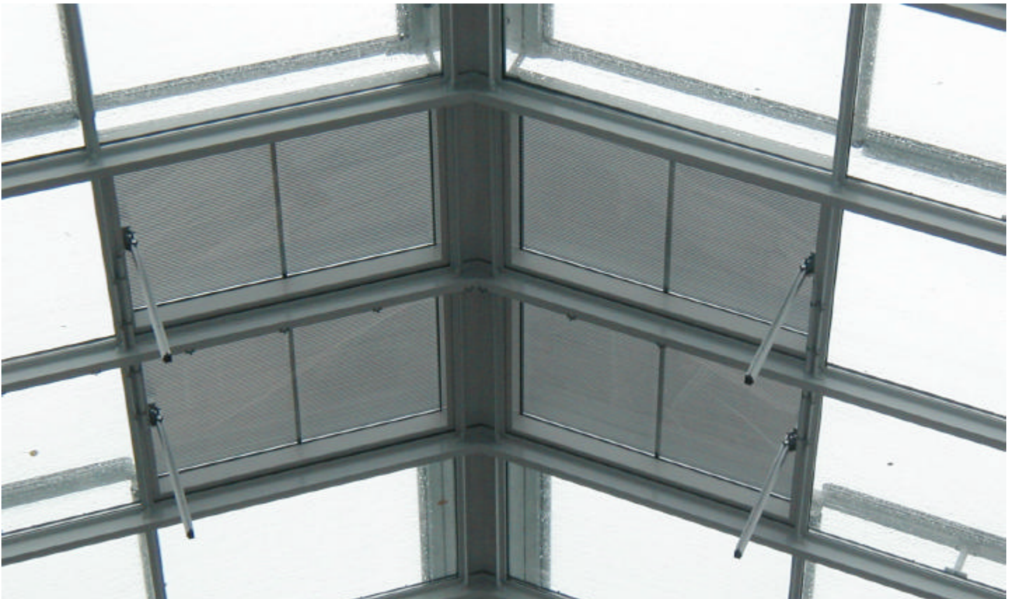
12 RWA-Klappflügel im Sattel-Glasdach / Öffnung 750 mm Glas-Lamellenfenster im EG als RWA-Zuluft
