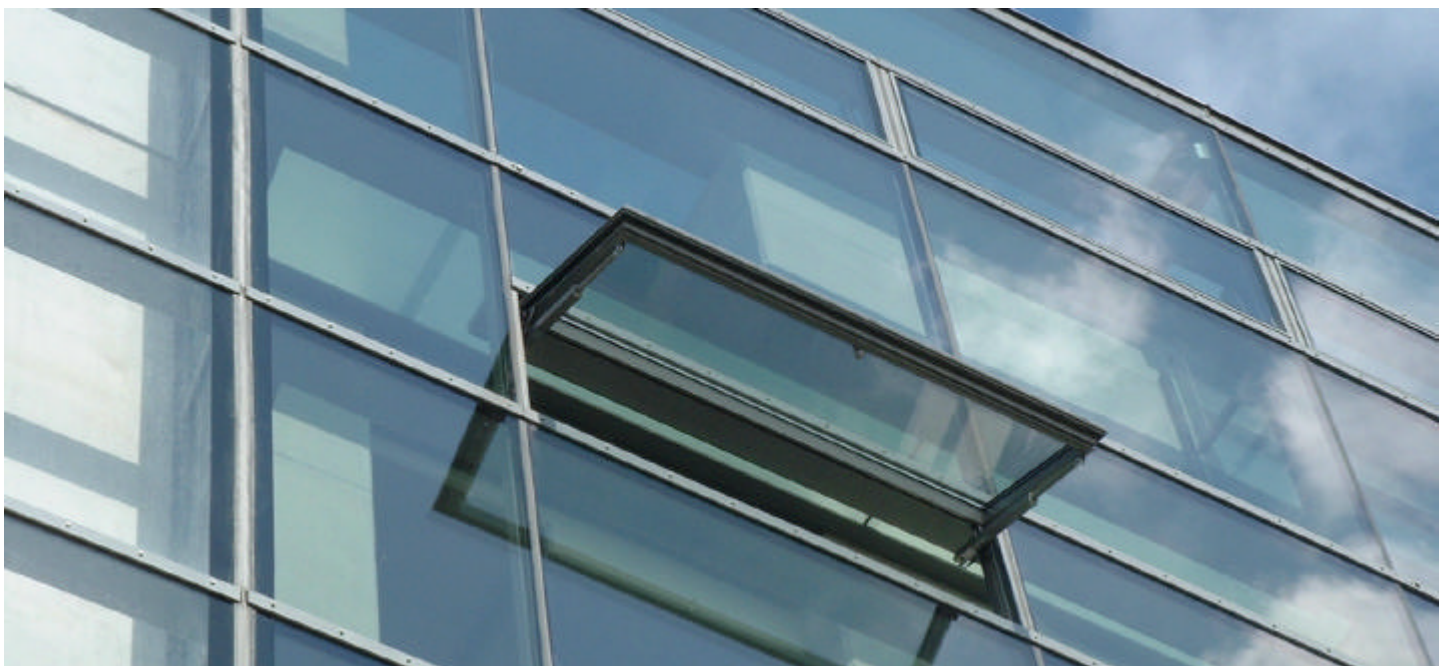
352 RWA-Senk-Klappflügel in der Glasfassade / Öffnung 70° gem. Brandsschutzgutachten HHP Braunschweig
