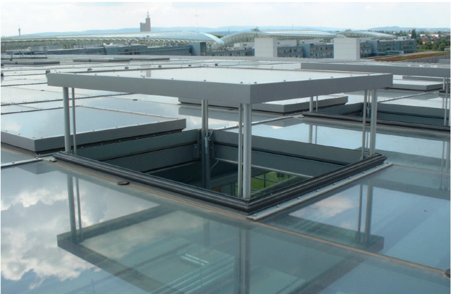
115 Dach-Hubflügel / Öffnung 500 mm gem. Brandsschutzgutachten HHP Braunschweig
